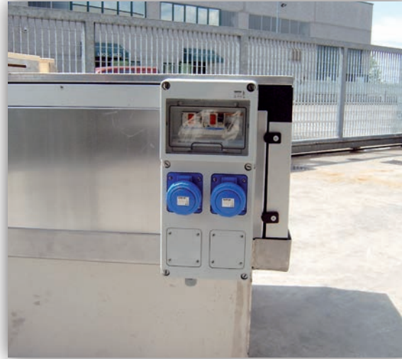
QUADRO ELETTRICO ELECTRIC PANEL
